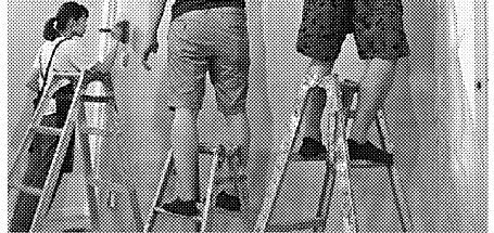
ペンキで壁を塗るなど入居者の希望を内装に反映する
